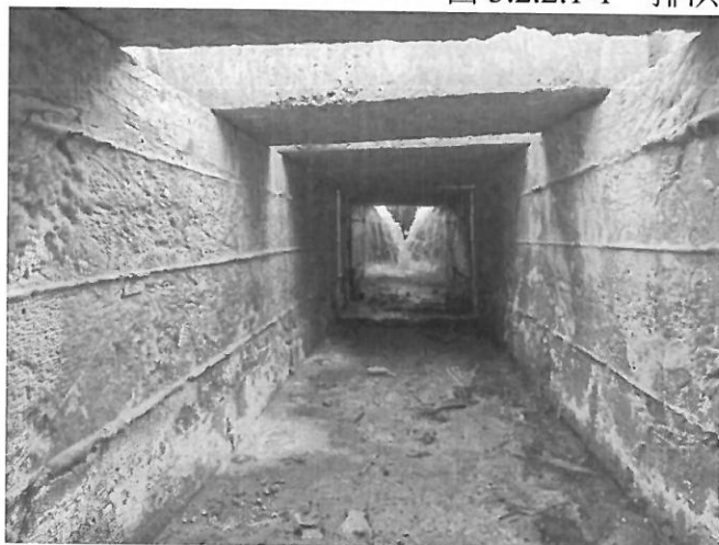
图 3.2.2.1-2 排洪系统排水斜槽内景
