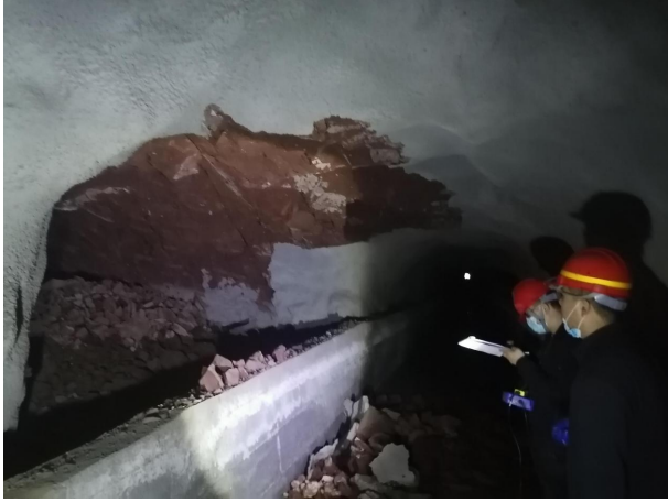
图 3.2.2.2-11 247-252 米处南边墙围岩脱落， 宽为 5.4 米，深 5.1 米
