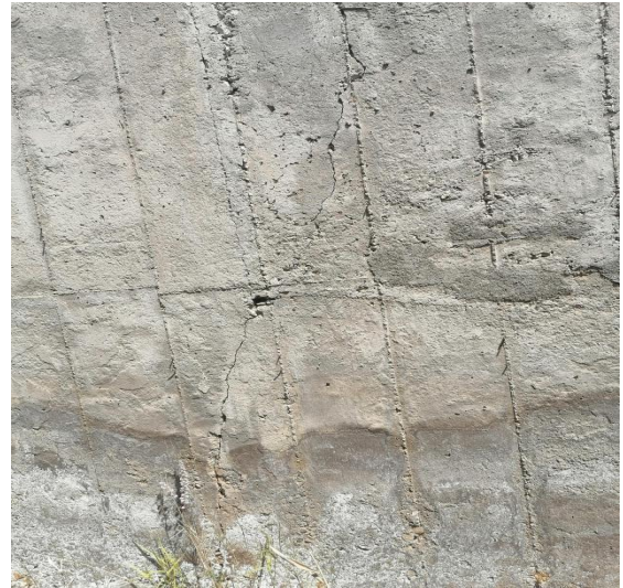
图 3.2.2.3-2 150 米处北边墙裂缝
