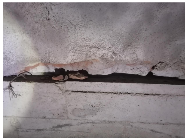
图 3.2.2.2-10 168 米处南边墙初喷混凝土脱落
