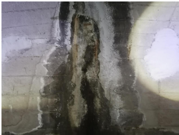
图 3.2.2.2-3 隧洞 15 米处南边墙混凝土脱落
