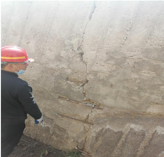
图 3.2.2.3-1 150 米处南边墙贯通裂缝
