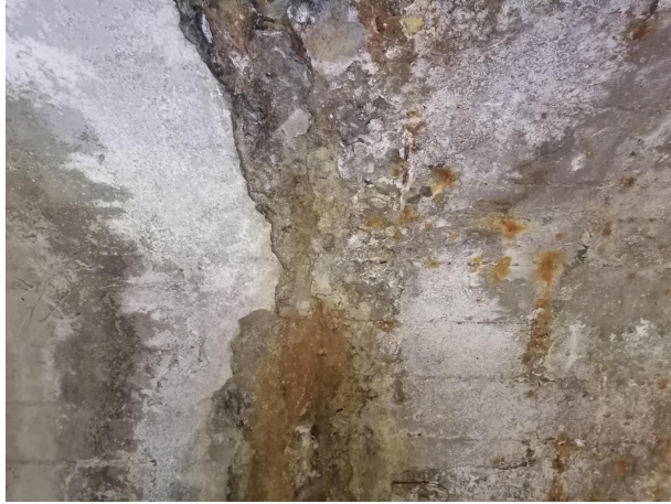
图 3.2.2.2-1 隧洞洞口拱顶混凝土脱落
