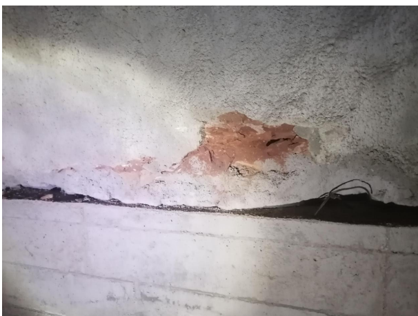
图 3.2.2.2-9 160 米处南边墙初喷混凝土脱落
