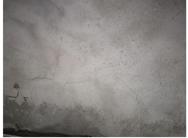
图 3.2.2.2-12 300 米处南边墙裂缝
